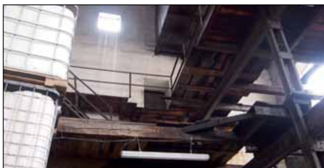
Přístup obsluhy do horní strojovny v hlavní budově.
