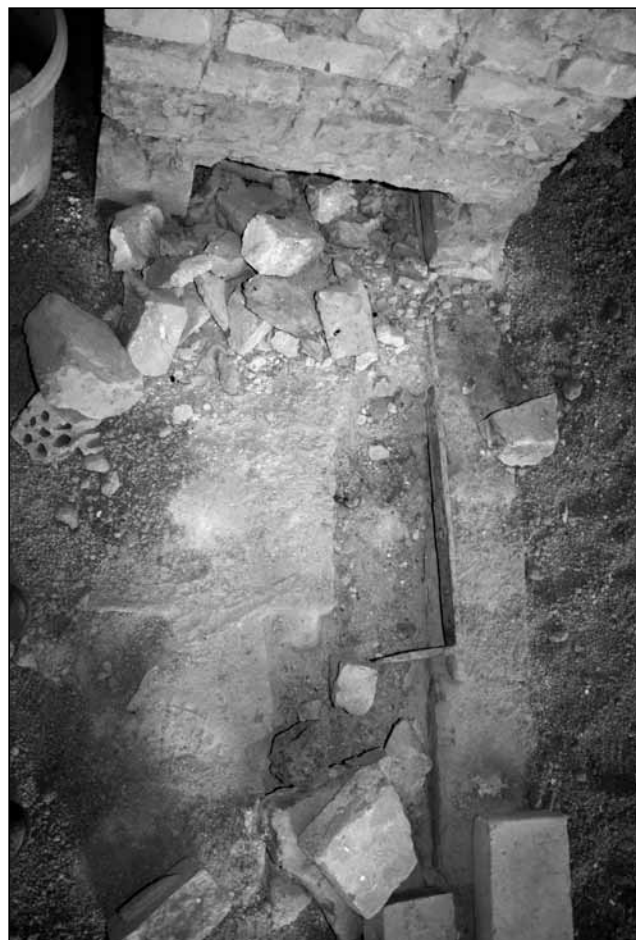
Jihozápadní stěna v místnosti 215 s kapsou po dřevěném věnci a železnou kramlí ke spojování trámů, foto 2008.
