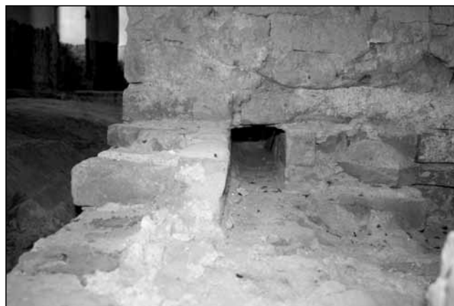
Otvor v cihlovém zdivu po dřevěném ztužujícím věnci, foto 2008.
