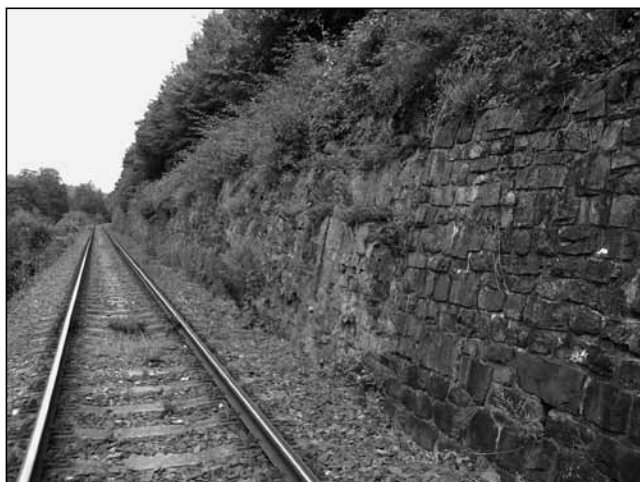
Železnice do Budišova nad Budišovkou s opěrnou zdí z roku 1883, za níž se skrývá čedičová žíla (Foto Vojtěch Šešulka).
